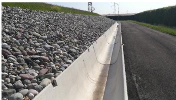
Foto 18: Canalette meteo lato ovest - maggio.
