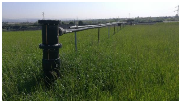
Foto 11: Linee e pozzi rete biogas – mese di maggio
