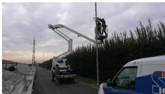
Foto 2: Manutenzione telecamere di sorveglianza - febbraio
