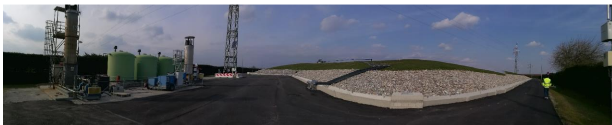
Foto 17: Cisterne di stoccaggio percolato e Torce di combustione T1 e T2 - mese di marzo.
