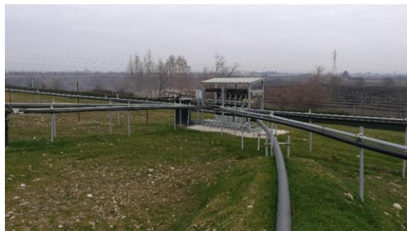
Foto 4: Sottostazione di regolazione biogas SRB- febbraio
