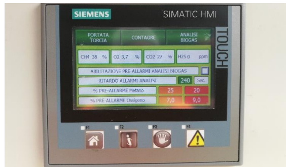
Foto 12: PLC torcia di combustione T1
