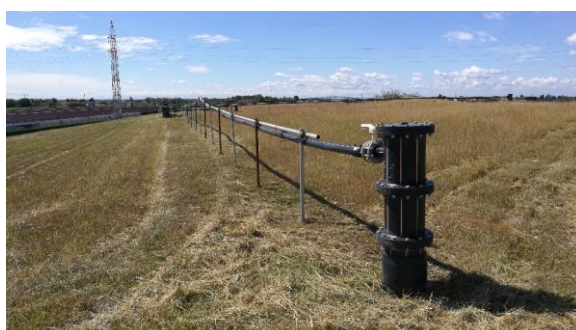
Foto 7: Linea captazione biogas - giugno
